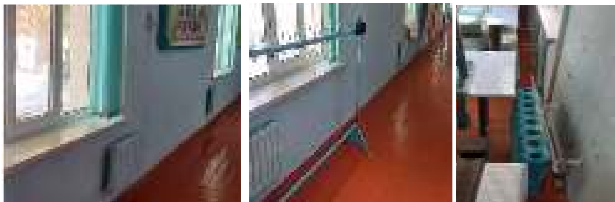
Рис.17, 18, 19 – Бетонные электроконвекторы в коридорах
